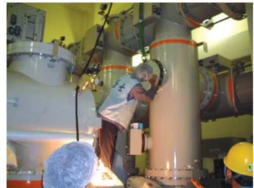
GIS設備保養 Maintenance
