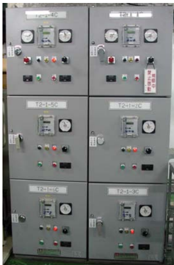
高壓馬達綜合啟動器 High Voltage Combination Starter
