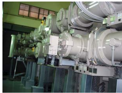
161/60KV GIS 操作 Operation
