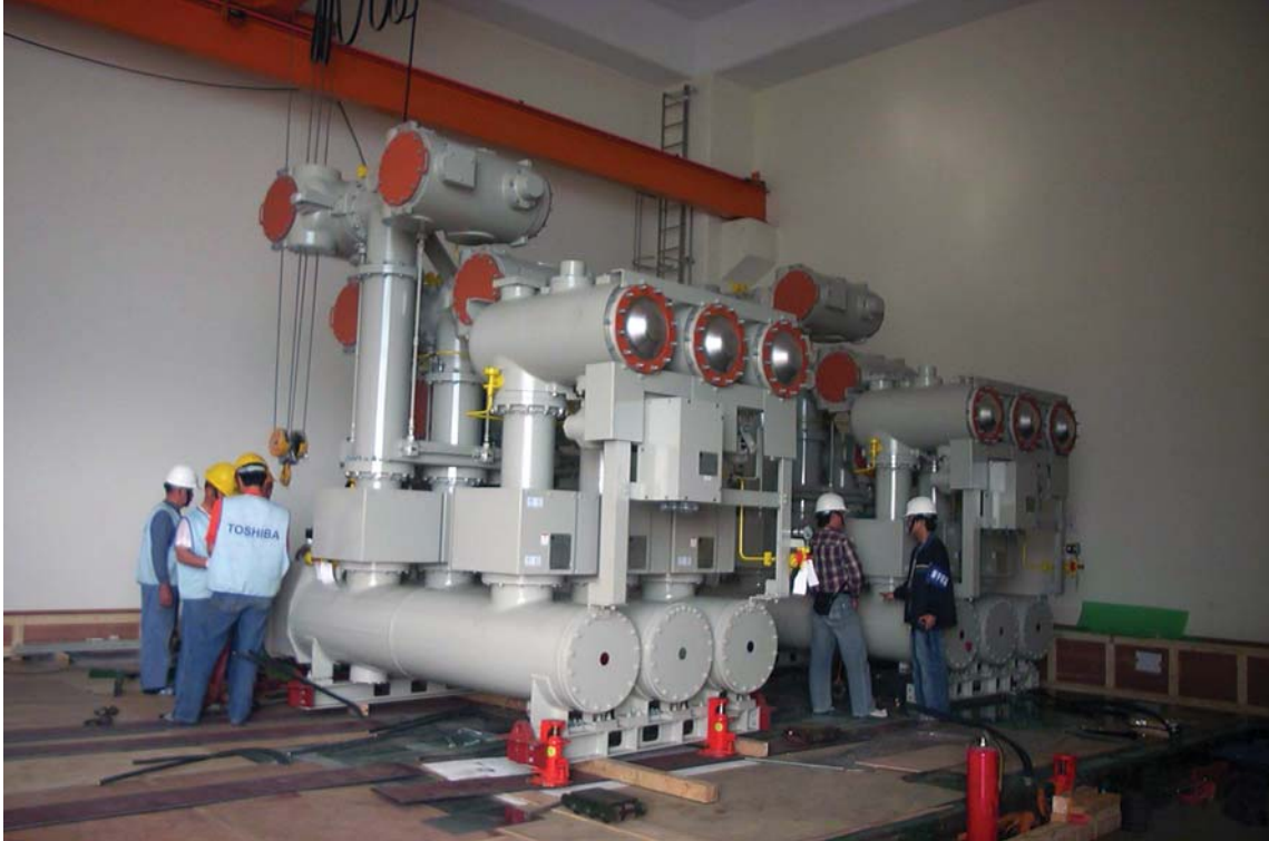
三相分管 161KV GIS (3phase separated enclosure)
