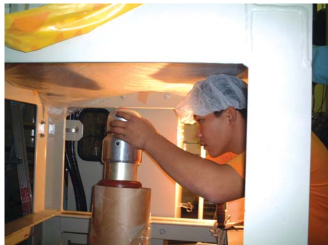
161KV 電纜頭與GIS接續 161KV GIS Cable head termination
